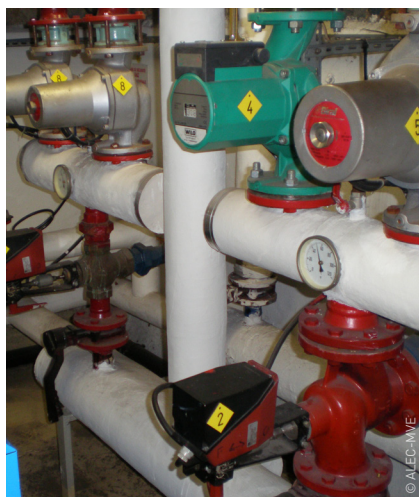
Réseaux de distribution en local chaufferie
