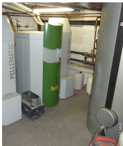
Chaudière biomasse et ballon d'eau chaude solaire
